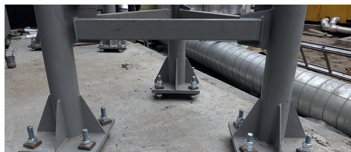
Закрепление опор труб газовой котельной: резьбовая шпилька M24, глубина заделки L=1200 мм (Центр дизайна «ARTPLAY», г. Москва, 2016 г.)
